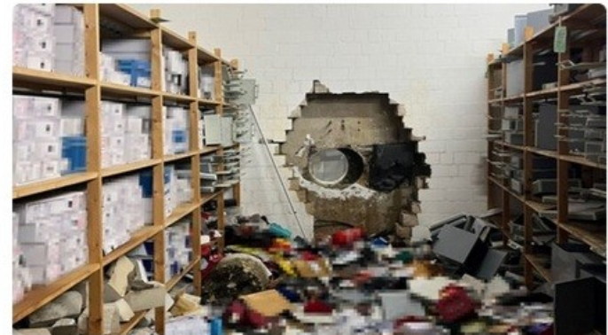
Loch in der Wand des Kellers einer Bankfiliale in Gelsenkirchen
